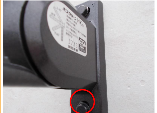
12 物干し金物 ボルト隙間
