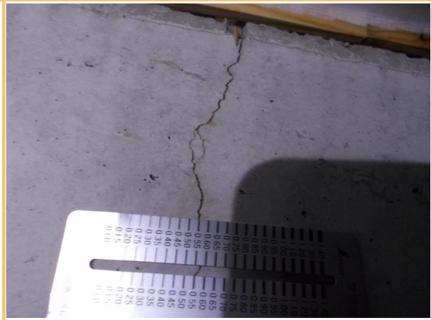
20 基礎 ひび割れ
